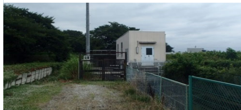
（関川排水機場）排水ポンプを増強予定
