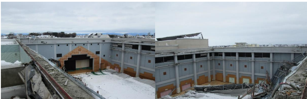
写真 市民総合体育館屋根崩落事故
