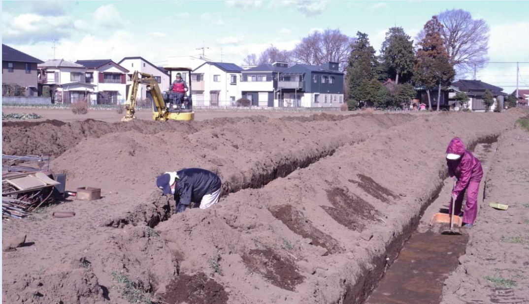
重機で掘った溝「トレンチ」の下面を、人力で平らに削り、土の色や硬さを観察する
