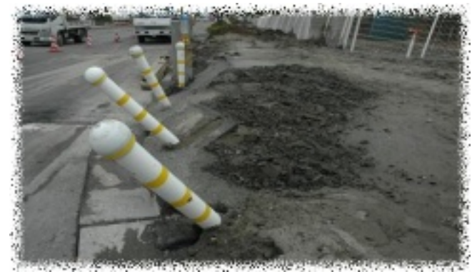
震度5弱で発生した液状化被害の状況(千葉)
