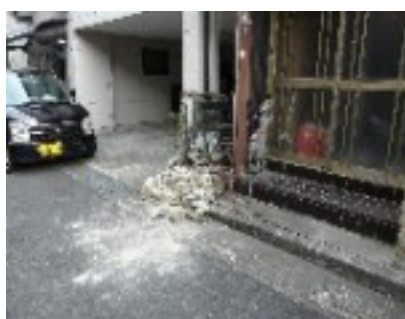
崩れたブロック塀(2丁目)
