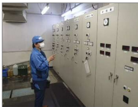
設備の巡回点検
