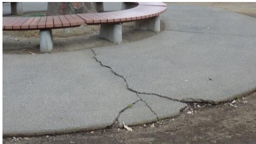
図 114 園路の損傷とサークルベンチの段差
