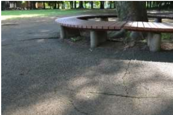
第 76 図 根上りにより破損した園路
