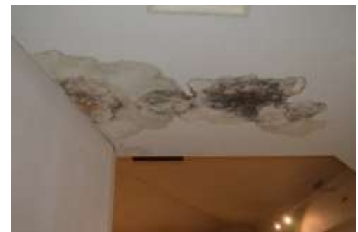
第 73 図 雨漏りによるシミ
